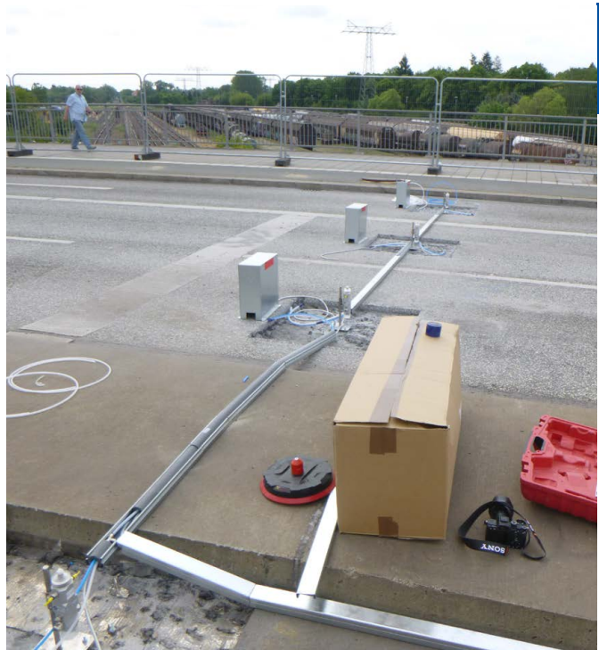
Abb. 33: Brücke des 20. Jahrestages am Altstädter Bahnhof – Installation der Messanlagen im Juni 2020, Foto: LS
