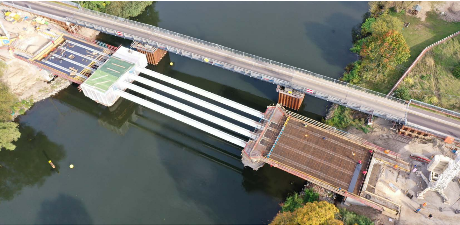
Abb. 5: Neubau der Brücke an der L 963 über die Havel bei Milow, Foto: LS
