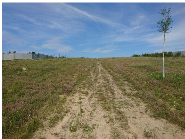
Abbildung 28: Rohbodenstellen auf der Grünbrücke
